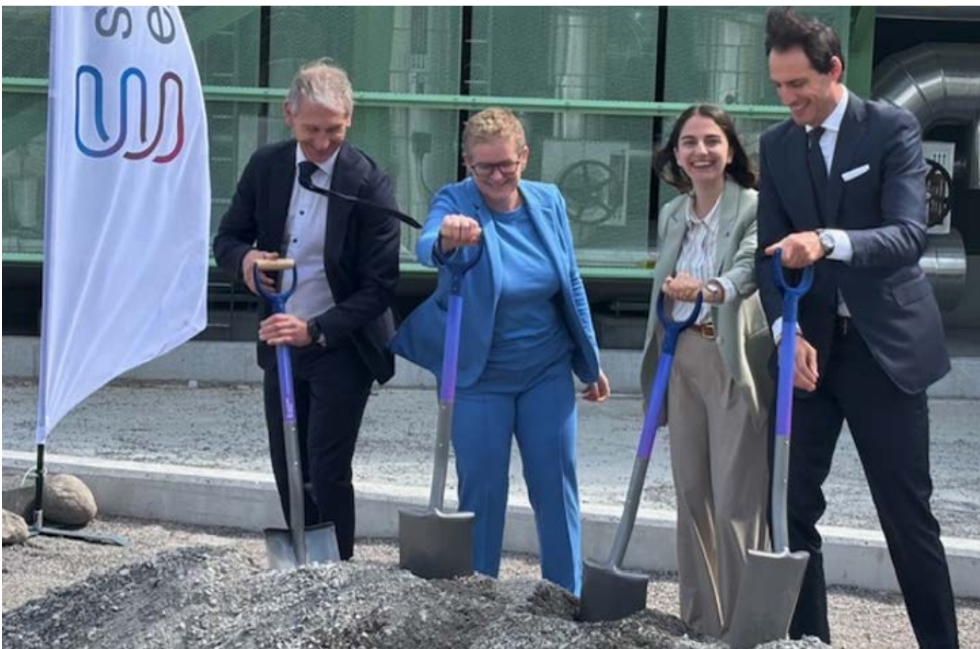
Det första spadtaget togs för en av världens största anläggningar för koldioxidinfångning, BECCS Stockholm (Bio Energy Carbon Capture and Storage). På bilden ser vi Stockholm Exergis vd Anders Egelrud, finansborgarrådet Karin Wanngård, klimat- och miljöminister Romina Pournokthari samt EU:s klimatkommissionär Wopke Hoekstra.
